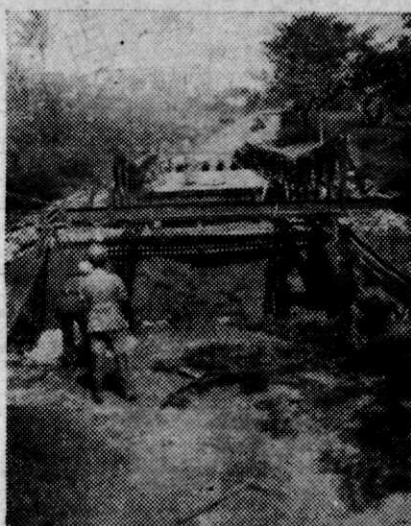
Afb. 11 Door het slaan van Baileybruggen over de vernielde duikers in de hoofdweg Bandoeng—Soemedang herstelt de 4 genievelddie de wegverbinding voor zwaar verkeer
