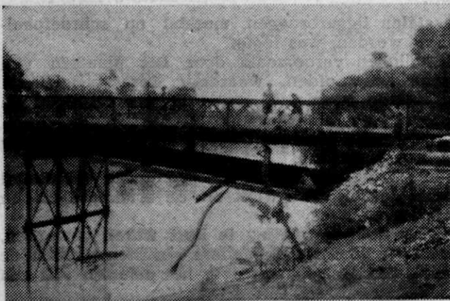
Afb. 13 Onder de tijdens actie geslagen Baileybrug over het W. landhoofdvak van de schroefpaalbrug over de Kali Losari in de hoofdweg Cheribon—Tegal begint de 16 Cie legergenietroepen met de permanente herstelling van dit brugvak
