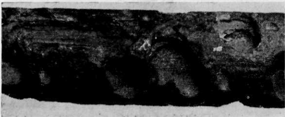
Afb. 7 Corrosie t.g.v. anaërobie
