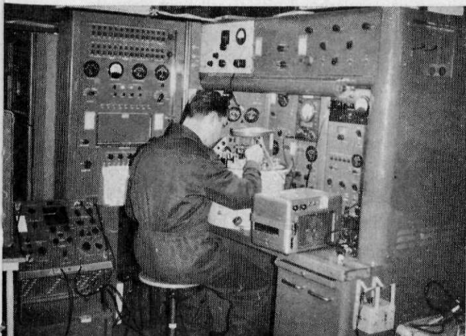
Afb. 2 Gedeelte van een NIKE-DSU-uitrusting van de GTM
