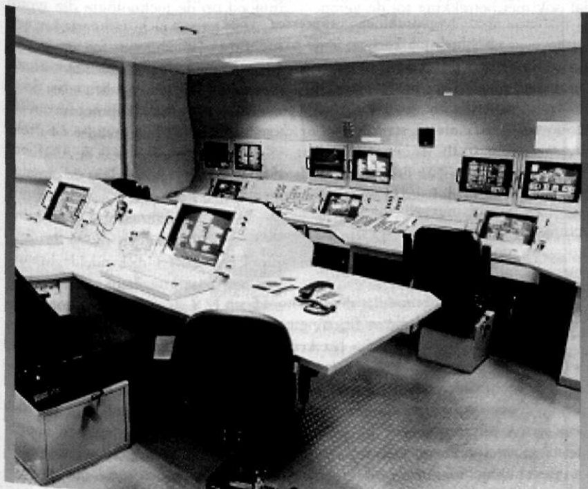
Afb. 2 Technische centrale aan boord van een M-fregat.
