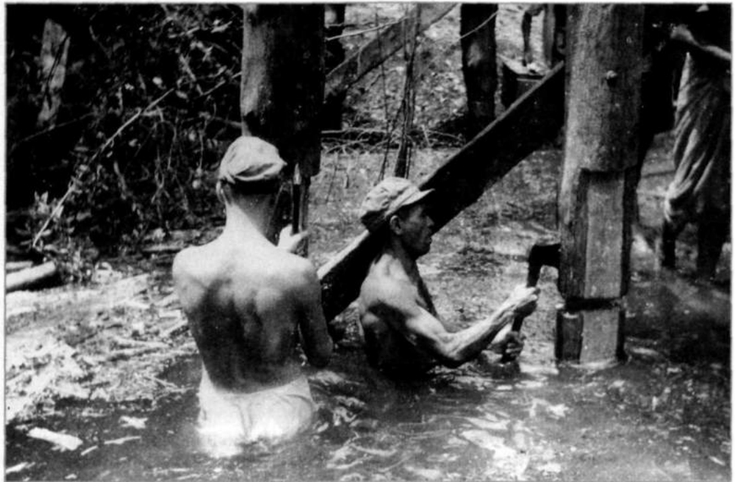
Afb. 3 Het verstevigen van een gedeeltelijk vernieelde jukbrug op Zuid-Sumatra door manschappen van 2 Genieveld- compagnie (1947)
