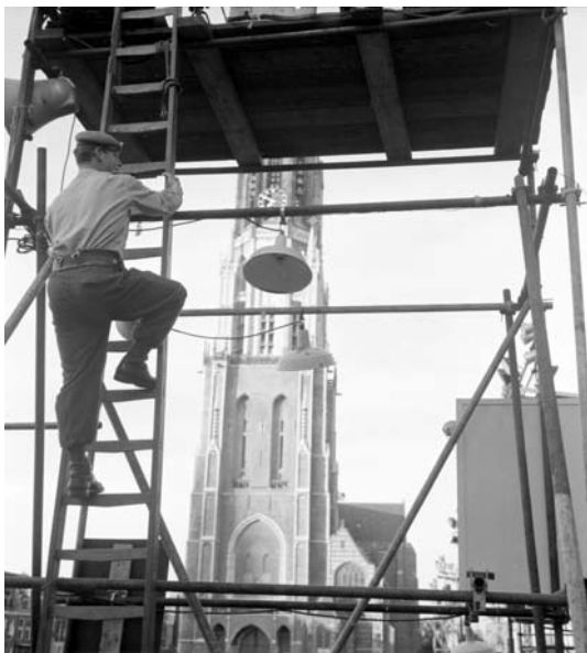
Opbouw van de tribunes en de technische installaties voor de taptoe Delft, augustus 1961
