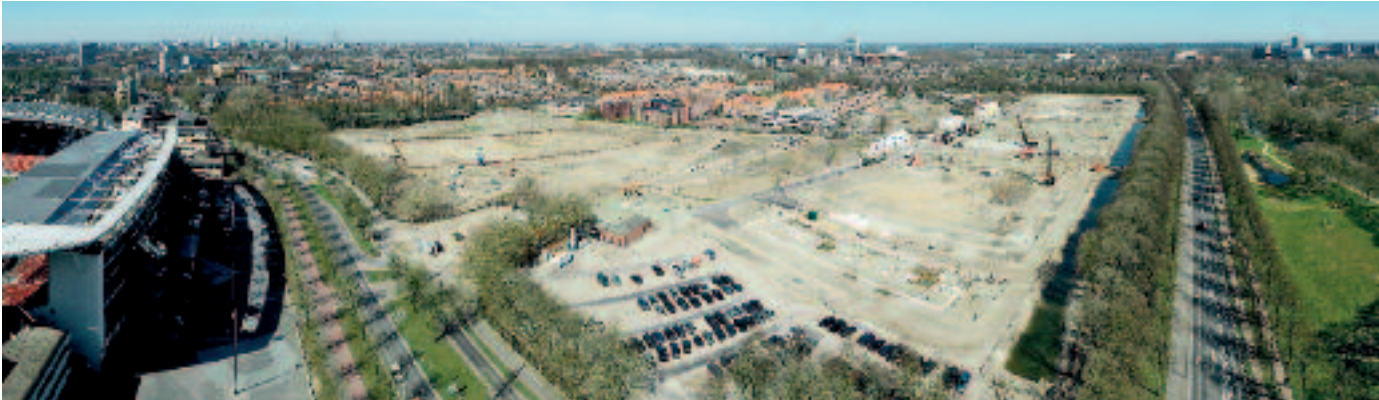
In 2010 verschijnt in Utrecht het nieuwe hoofdkwartier van het Operationele Commando Landstrijdkrachten. Het winnende private consortium is begonnen om het terrein van de Kromhoutkazerne bouwrijp te maken
