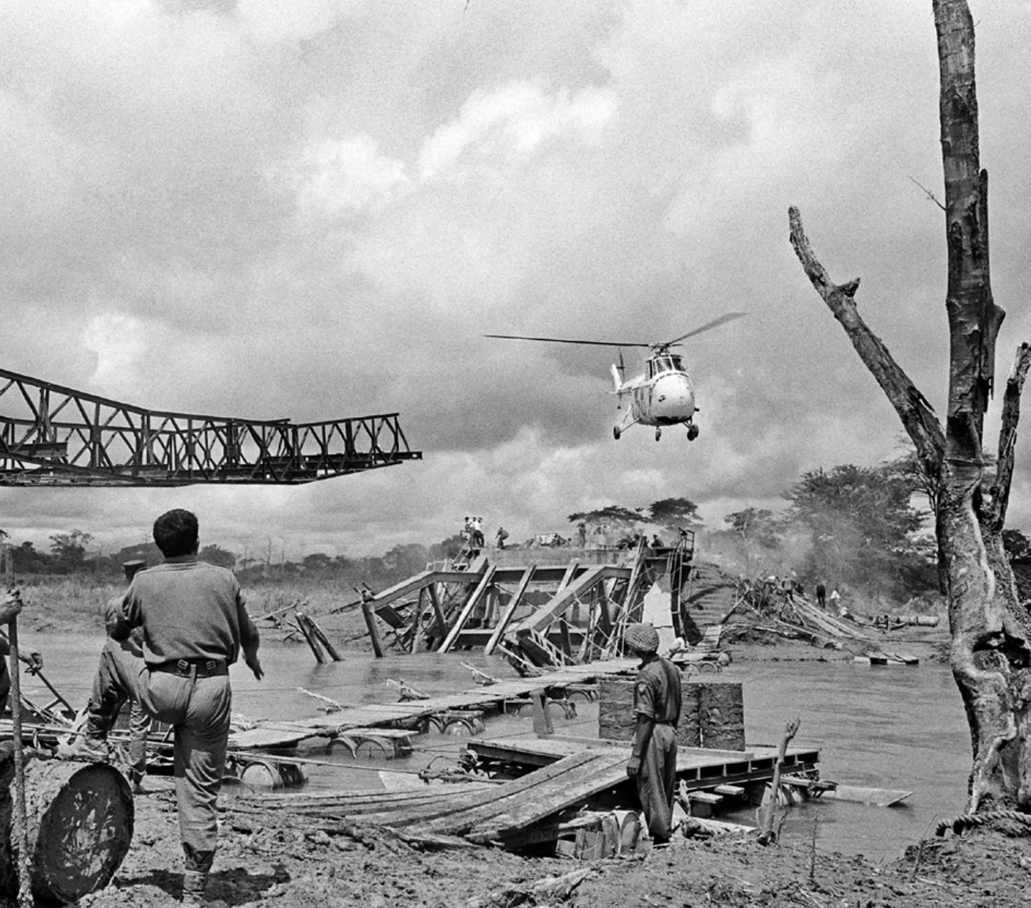
ONUC-militairen helpen bij de reparatie van een verwoeste brug over de Lufira-rivier in de provincie Katanga (januari 1963)
